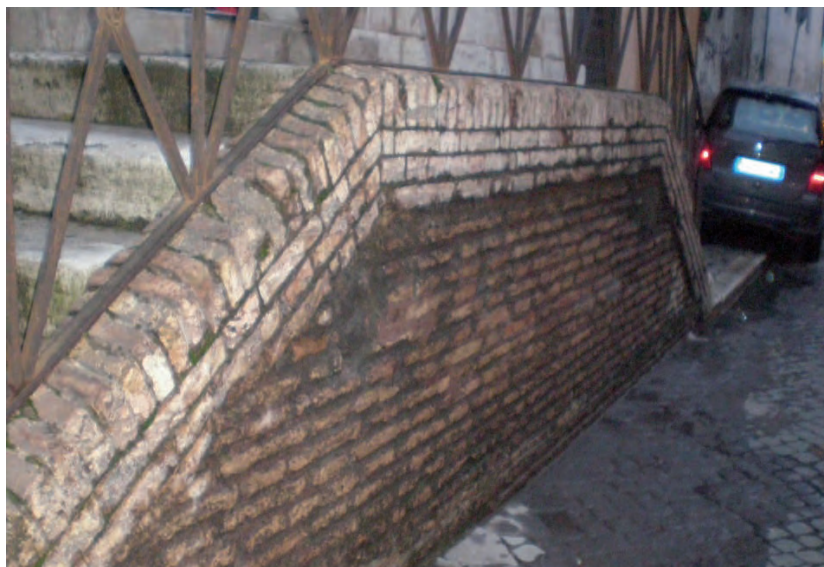
Fig. 3.17 – Degradato generalizzato delle scale principali, in particolare della muratura e dei gradini.
