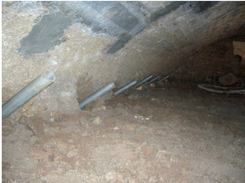
Fig. 4.10 – Posizionamento, nel foro realizzato nel terreno, dell'armatura del palo, costituita da tubi in acciaio speciale.
