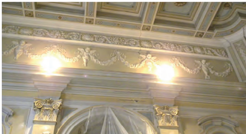
Fig. 3.06 – Quadro fessurativo sul fregio seicentesco, le fessure hanno sia andamento longitudinale che trasversale.
