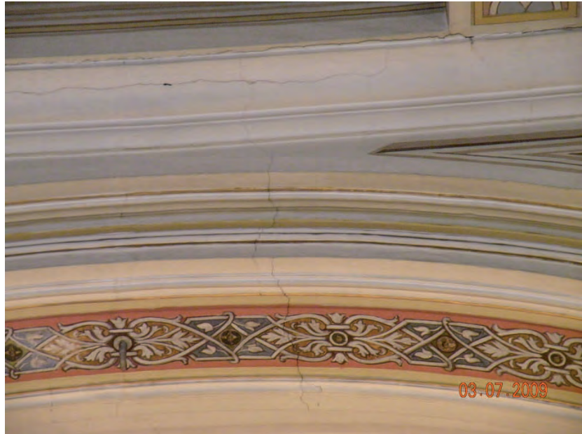
Fig. 3.07 – Quadro fessurativo sull'arco trionfale.
