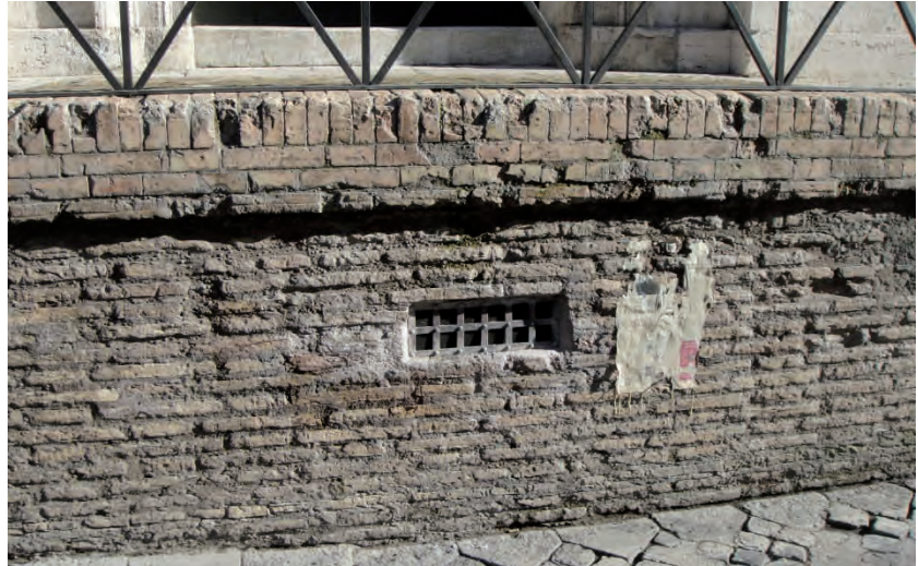
Fig. 5.16 – Griglia di areazione del vano seminterrato.
