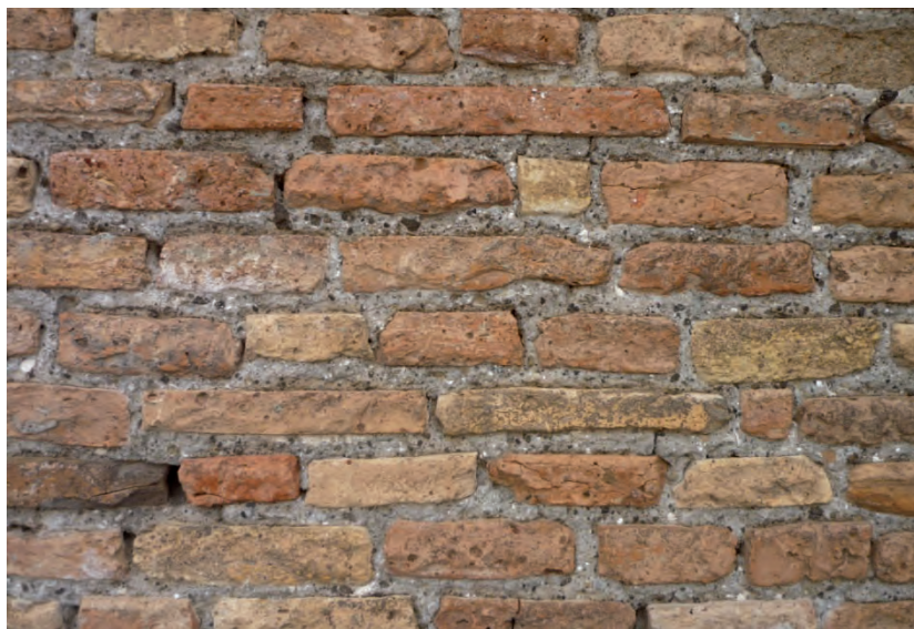
Fig. 3.16 – Dettaglio della muratura del campanile; sono presenti numerosi fenomeni degradanti; in particolare l'erosione, l'efflorescenza e l'alveolizzazione.
