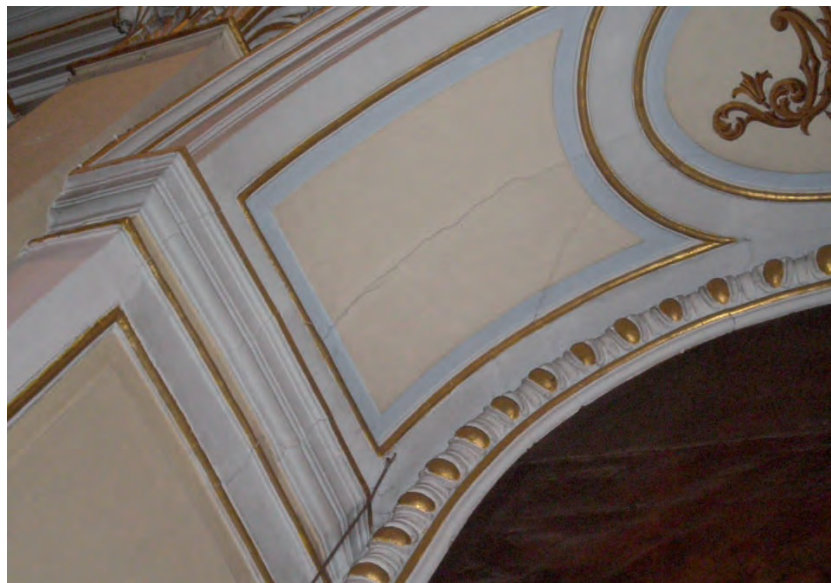
Fig. 3.08 – Quadro fessurativo sulla voltina a botte della cappella laterale.
