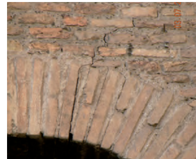
Fig. 3.10 – Particolare dall'esterno di una fessura dell'arco di una delle celle campanarie che sono inglobate all'interno del complesso monastico.
