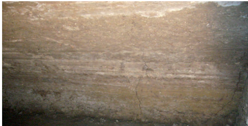
Fig. 3.02 – Quadro fessurativo all'intradosso della volta a botte sottostante l'aula principale. Dettaglio di una fessura.
