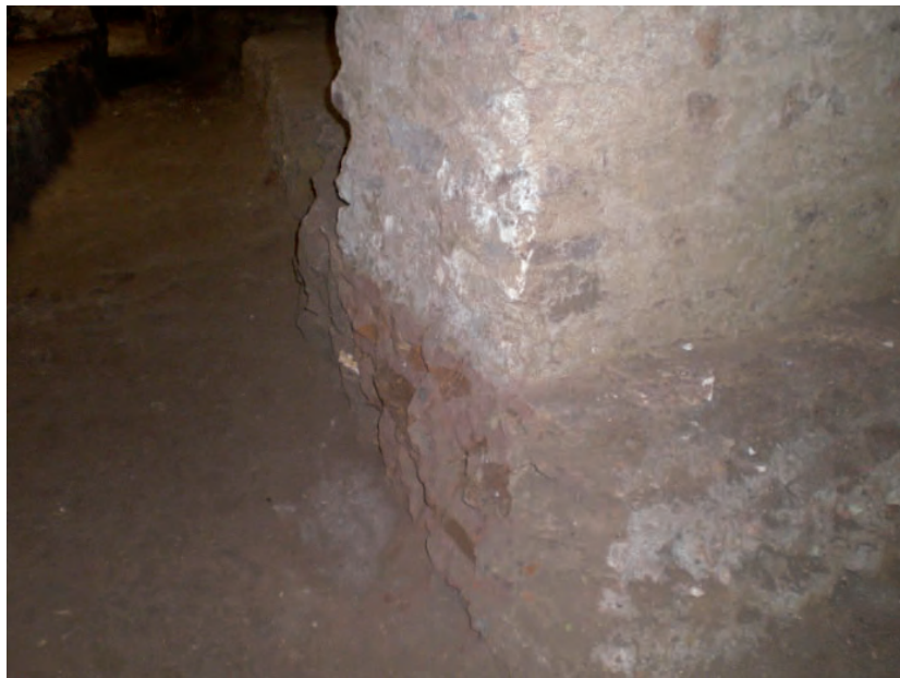
Fig. 2.47 – Fotografia in dettaglio della zoccolatura alta 40 cm presente su tutto il perimetro dei locali seminterrati. Tale zoccolatura è realizzata con materiali e tessitura diverse rispetto alle murature soprastanti. Se ne deduce che sia stata realizzata precedentemente.
