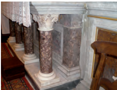
Fig. 5.08 – Elementi marmorei dell'altare principale fortemente degradati.
