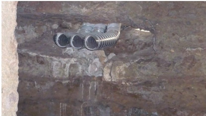
Fig. 5.15 – Tubi di areazione visti dall'interno del locale seminterrato.
