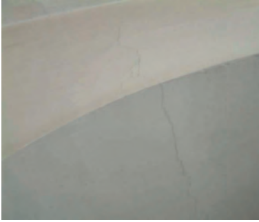
Fig. 3.12 – Particolare dall'interno della stessa fessura di Fig. 3.11.
