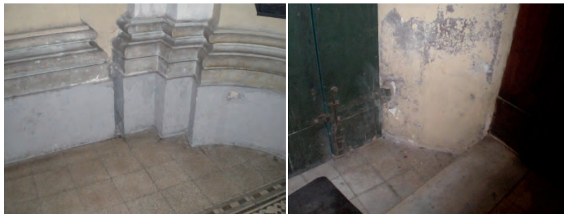
Fig. 3.14a – Risalita capillare e distacco dell'intonaco sullo zoccolo della Chiesa.
