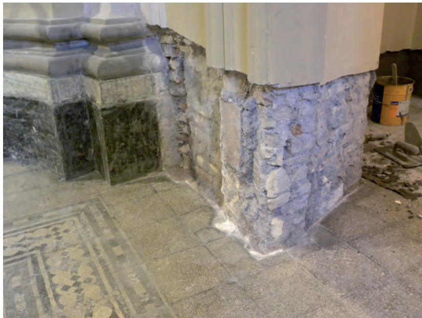
Fig. 5.01 – Eliminazione della tinta e dell'intonaco ammalo rato a causa della risalita capillare..
