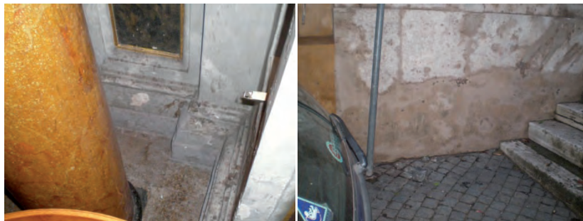
Fig. 3.15a – Risalita capillare e distacco dell'intonaco nel presbiterio.
