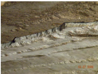
Fig. 3.04 – Particolare del disassamento di una delle fessure della volta del seminterrato.
