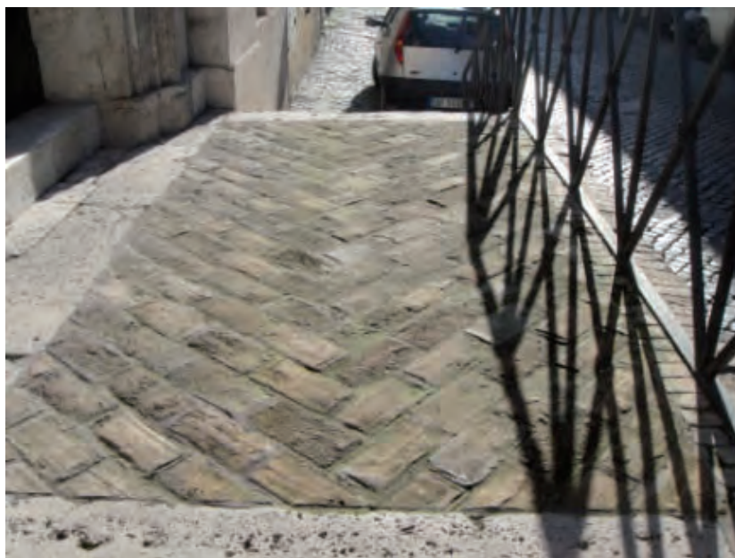
Fig. 5.14 – Pianerottolo della scala esterna dopo la sostituzione della vecchia e degradata pavimentazione con la nuova.
